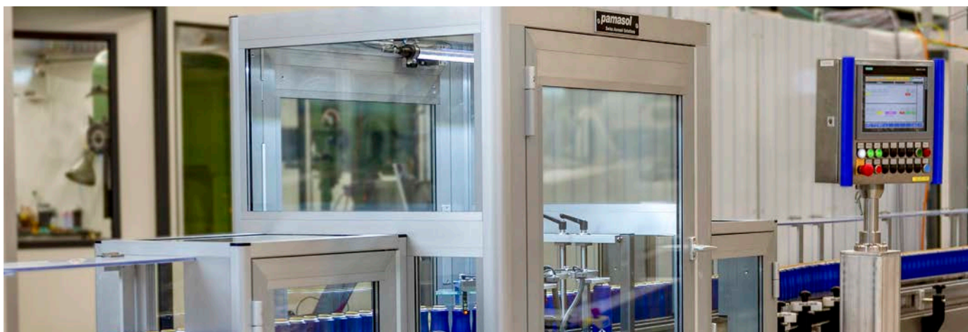
L'intérieur de la ligne de production (zone 2 ATEX) est illuminé par un éclairage LED Banner.
