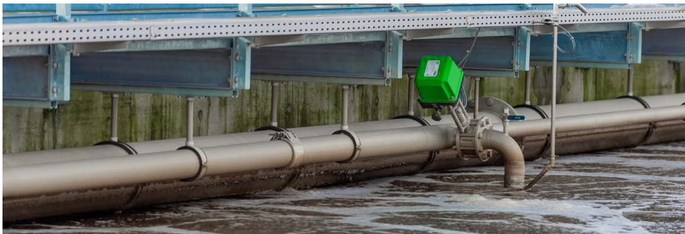
La régulation précise de la teneur en oxygène dans les unités biologiques est assurée par la vanne de régulation à glissière.
