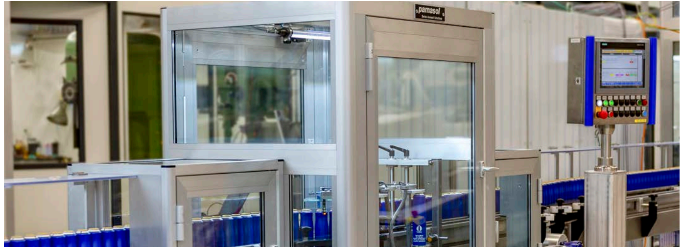
Der Innenbereich der Produktionsstrasse (ATEX Zone 2) wird durch das LED-Leuchtmittel von Banner ausgeleuchtet.
